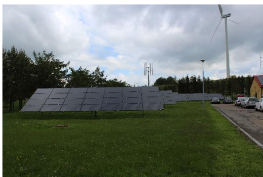
Instalacja fotowoltaiczna – Oczyszczalnia Ścieków w Rymanowie
