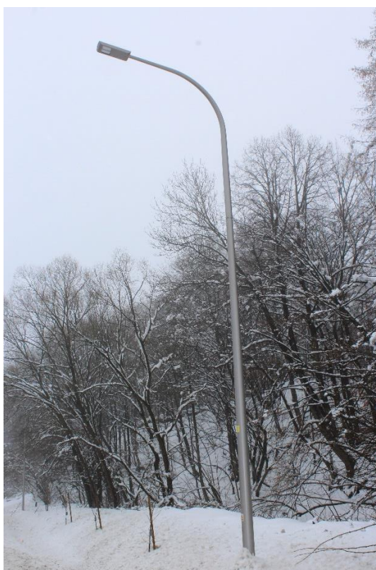
Energooszczędne oświetlenie uliczne typu „led”.
